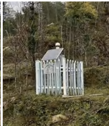
浙江温州泰顺某县地质灾害 监测站安装完成图 2
