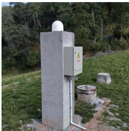
福建双旗山金矿尾矿库在线监测 图 02
