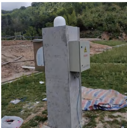
福建双旗山金矿尾矿库在线监测 图 01
