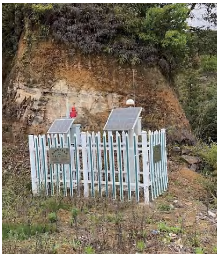
浙江温州泰顺某县地质灾害 监测站安装完成图 1
