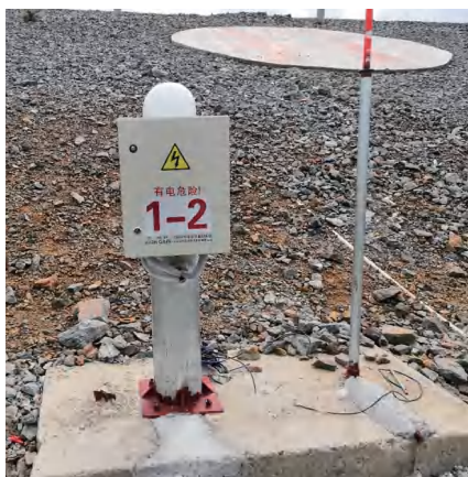
内蒙古银都矿业尾矿库在线监测 图 01
